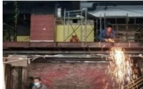
图例 5-2: 动火作业未做安全防护措施
