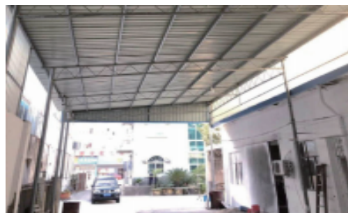
图 2-2 防火间距内空间被雨棚占用
